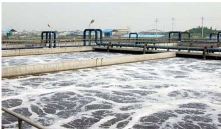
新建成的吴江市松陵污水处理厂 1.5 万吨每日的处理设施正在运转(摄于 2007 年 3 月)
