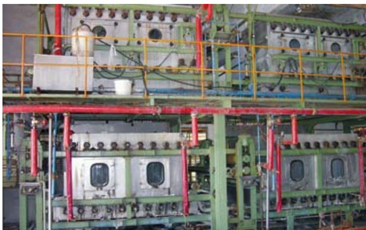
2007年12月,吴江新民纺织印染厂的碱液回收利用设施正在运转
