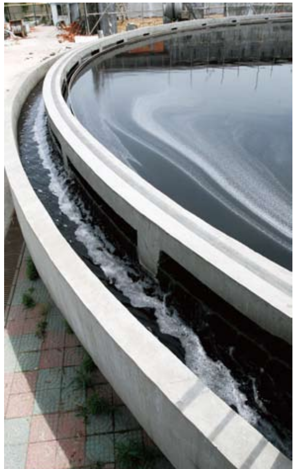
吴江市恒宇纺织染整有限公司的中水回用设施(摄于 2007 年夏)
