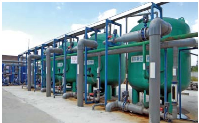
2008年夏,吴江市苏州龙英织染有限公司经过提标改造的废水处理设施
