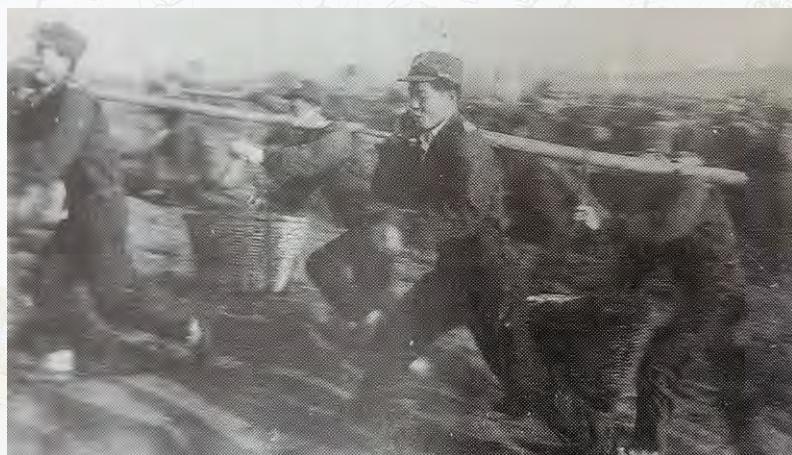
武警部队战士奋战在太浦河（上海段）工地（青浦区档案馆提供）
